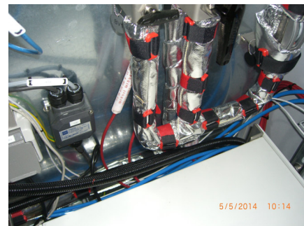
Isolierung eines Analysenschrank-bei 180°C
